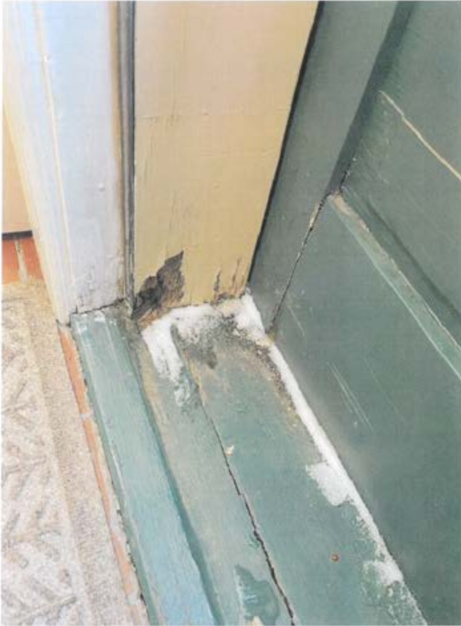
Rotten door threshold
